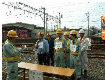
(復旧作業報告)
